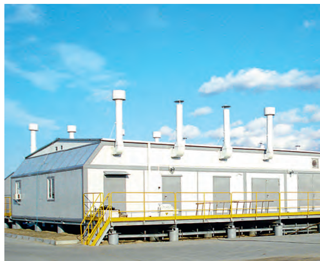
Блочная кустовая насосная станция для ООО РН-Пурнефтегаз
